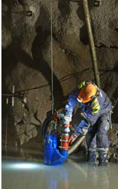
Vedenpoistoa haastavissa kaivosolosuhteissa
